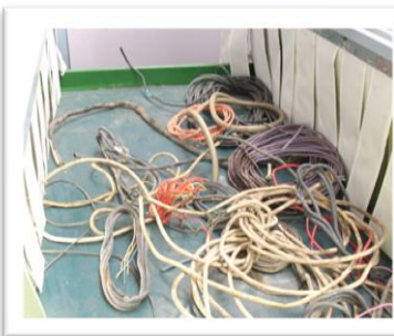
Cables antes del análisis
